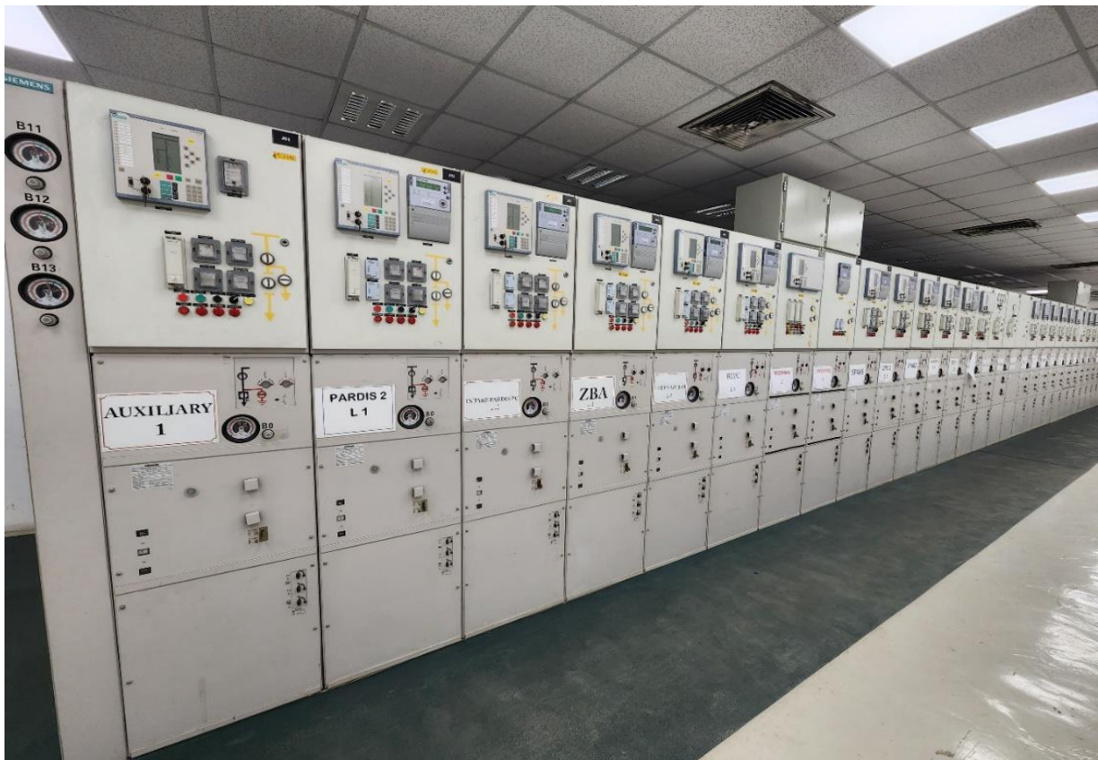
تصویر ۱- پست برق فشار قوی GIS نیروگاه شرکت مبین انرژی خلیج فارس
